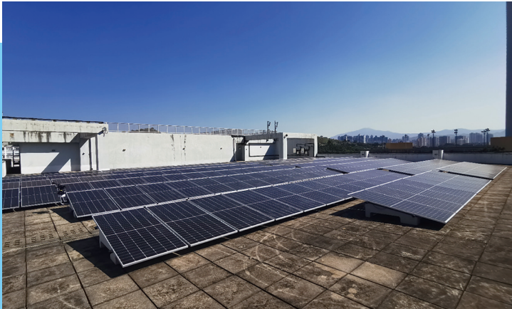
天水圍電話機樓的太陽能發電系統
