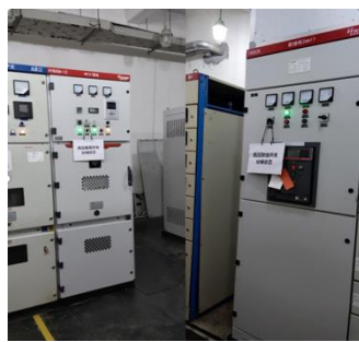
【高低压配电房改造】
