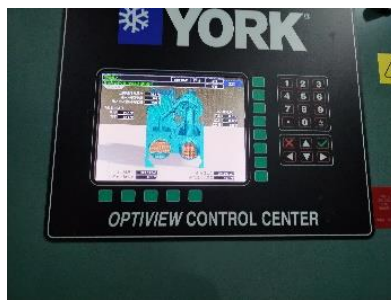
【磁悬浮监控系统】
