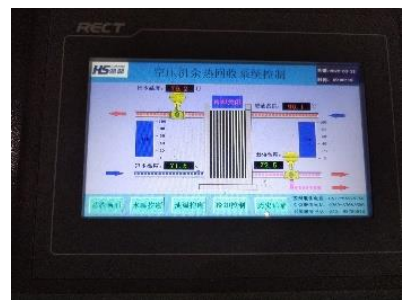
【余热回收监控系统】
