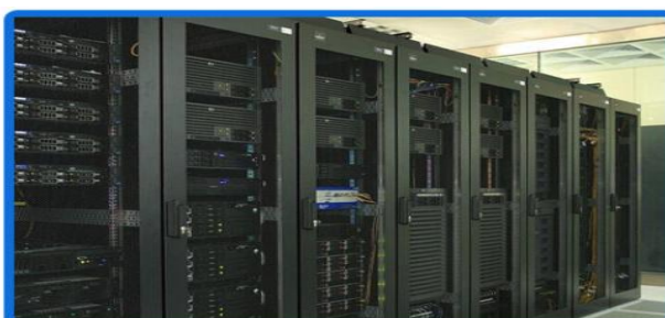
电信大数据机房交换机管理
