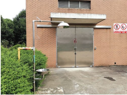
工廠操作區域配備洗眼器
