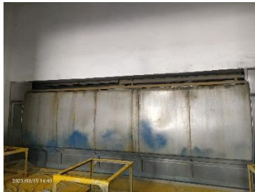
噴漆廢氣水簾收集
