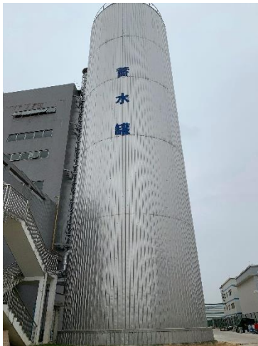
儲水罐 - 蓄冷／空調設備
