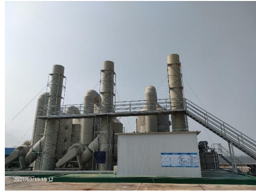
酸霧廢氣處理設施
