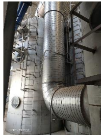
噴漆廢氣噴淋塔
