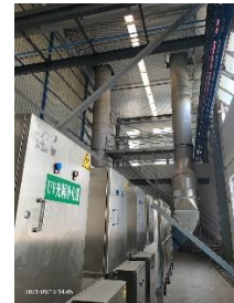
噴漆廢氣 UV 光解及高空排放
