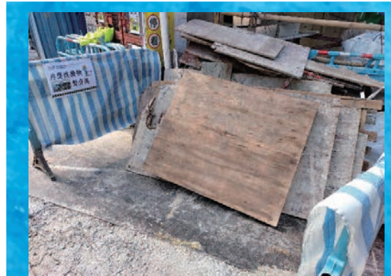
Separation of non-inert waste at the construction site 建築工地上的非惰性廢物分類
