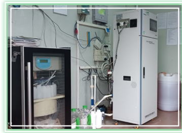
污水在線監測設備
