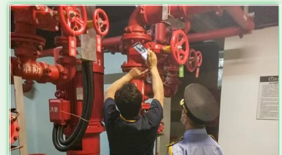
檢查消防水泵
