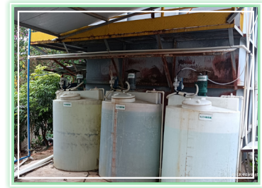
污水除磷設備
