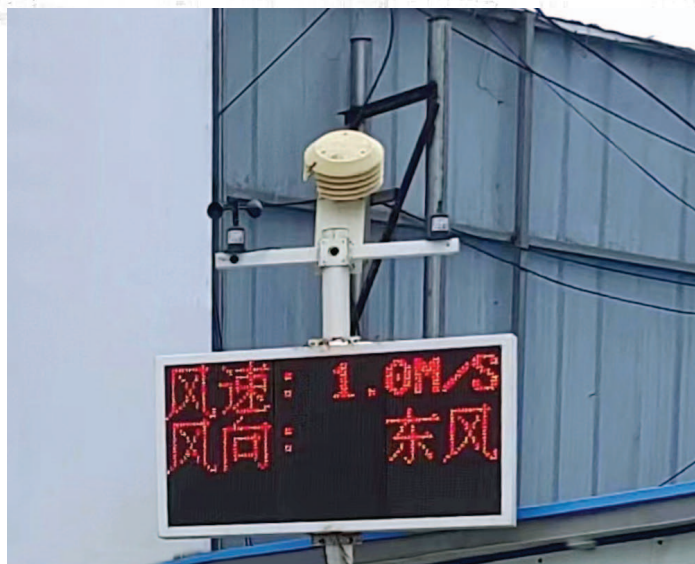
設置於工地的空氣質素監測系統
