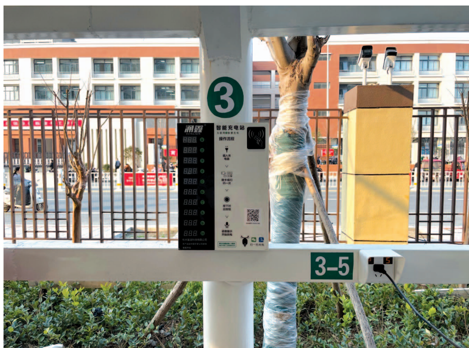
設置於息縣康橋學苑項目的電動汽車交流充電樁
