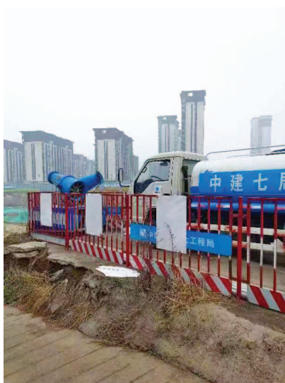
設置於工地各處的降塵裝置
