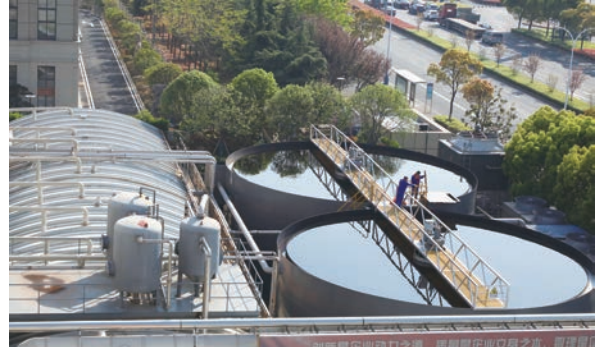
亞東常州中水回用二沉池
