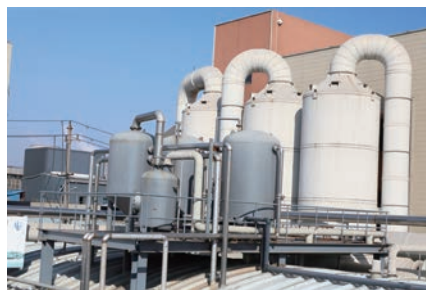
污水站厭氧池
