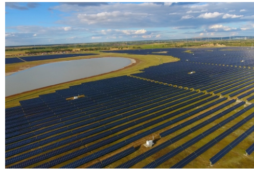
张北禾润光伏项目
