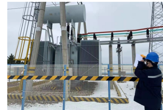
华东区域公司章广风电场运检员 春节期间进行日常维护
