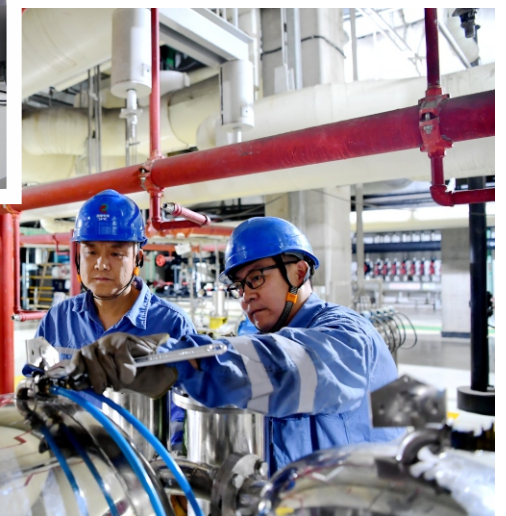
白城发电公司设备部员工在对2号机主机油净化器进行检修
