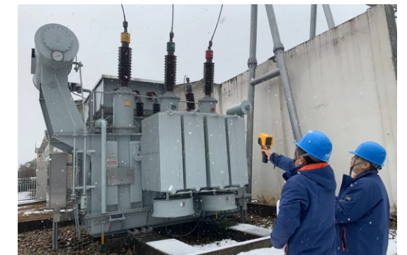
华中区域公司员工春节期间进行升压站巡检
