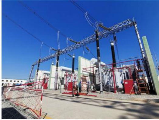
国网淄博供电公司 110kV 八陡等 5 座变电站消防设备设施维修工程等 3 个工程
