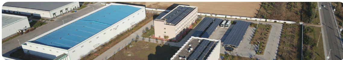
乳山工业园分布式光伏发电站
