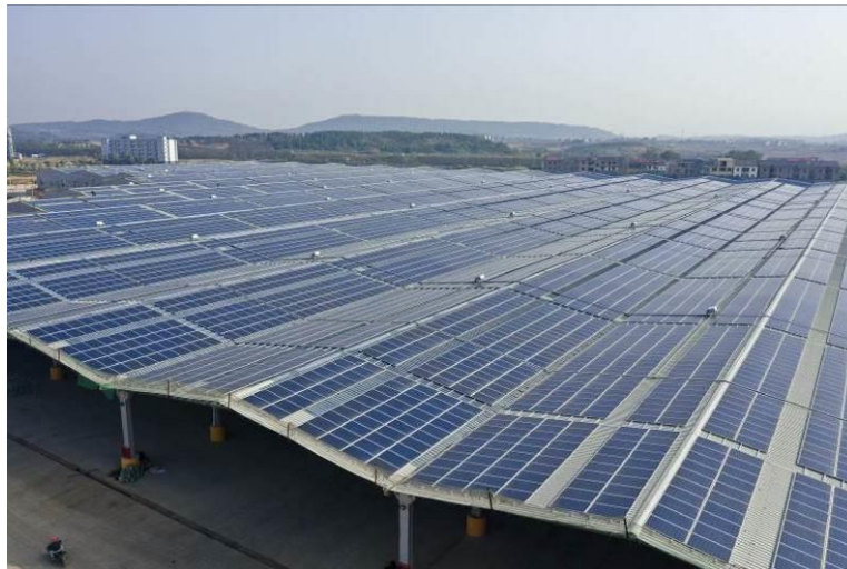
发行人江西丰城生产基地光伏厂房
