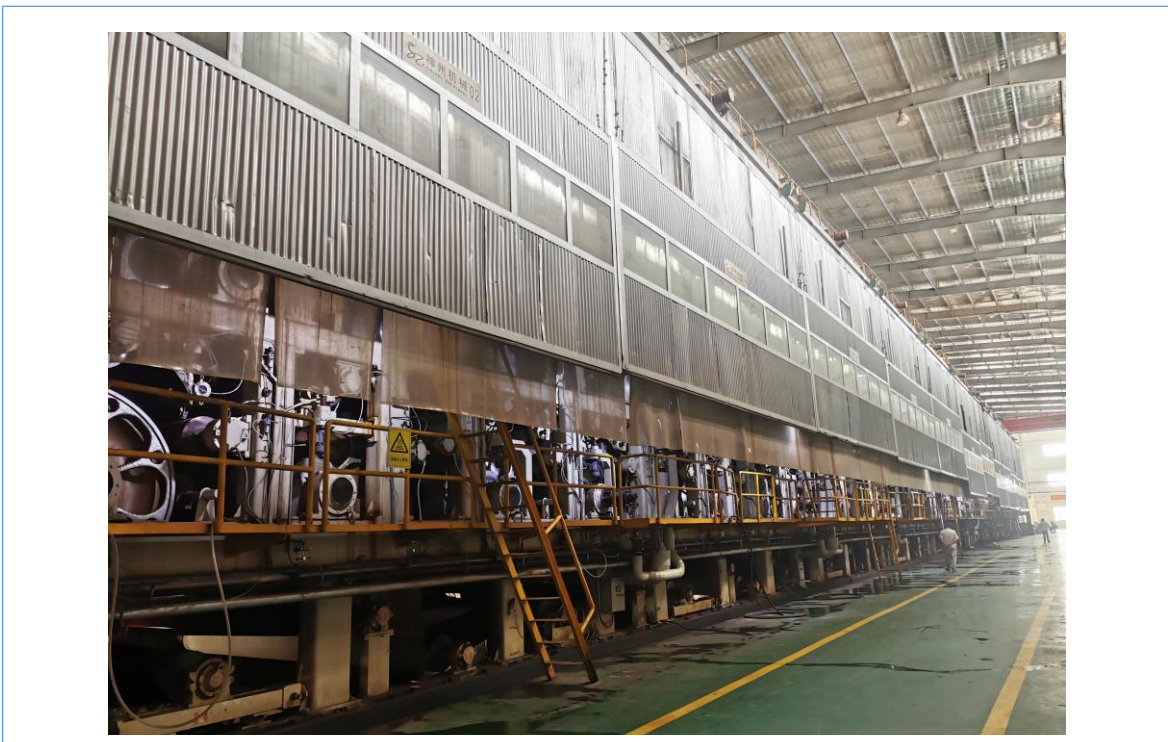
2022 年 10 月公司下旬一期技改完成开机运行
