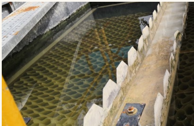
污水處理裝置
