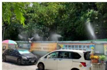
安裝自動灑水器系統
