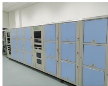
宽带电力载波通信检测系统
