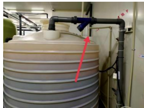
真空冷却水回水接到纯水机原水箱
