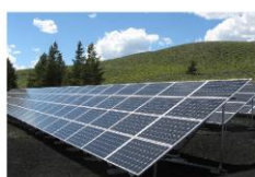
太阳能电池 Solar Battery
