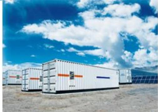
阿右旗雅布赖镇 10MW 光伏发电
