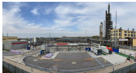
兆瓦级可再生电力电解水制氢项目
