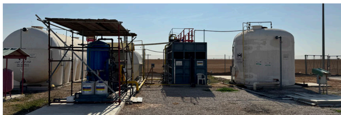
营地内的污水处理设备
