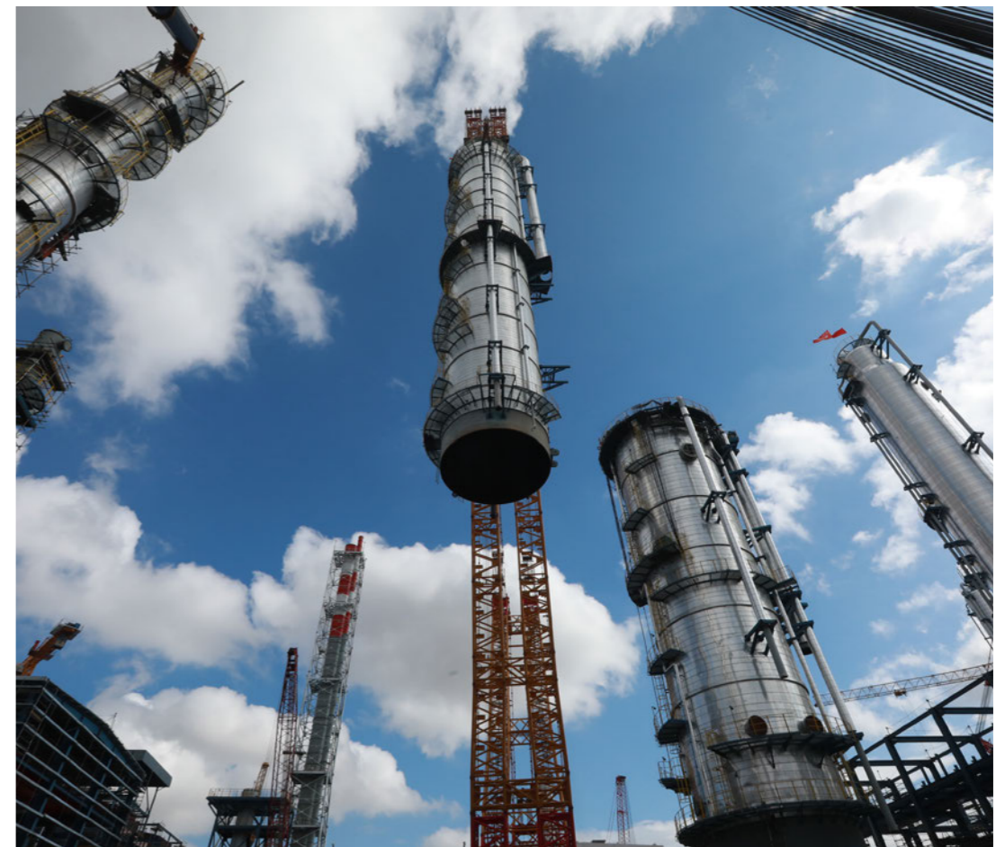
“镇海炼化 60 万吨 / 年丙烷脱氢”首套装置
