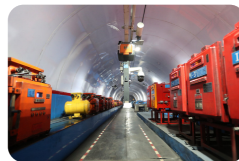
● 无人值守巡检机器人
