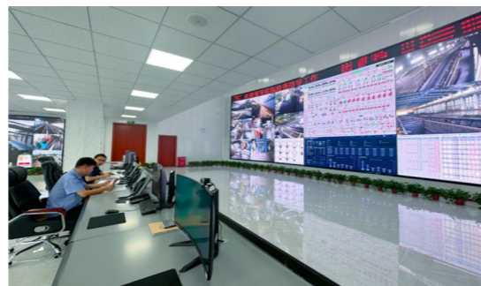
• 田庄选煤厂中控室
