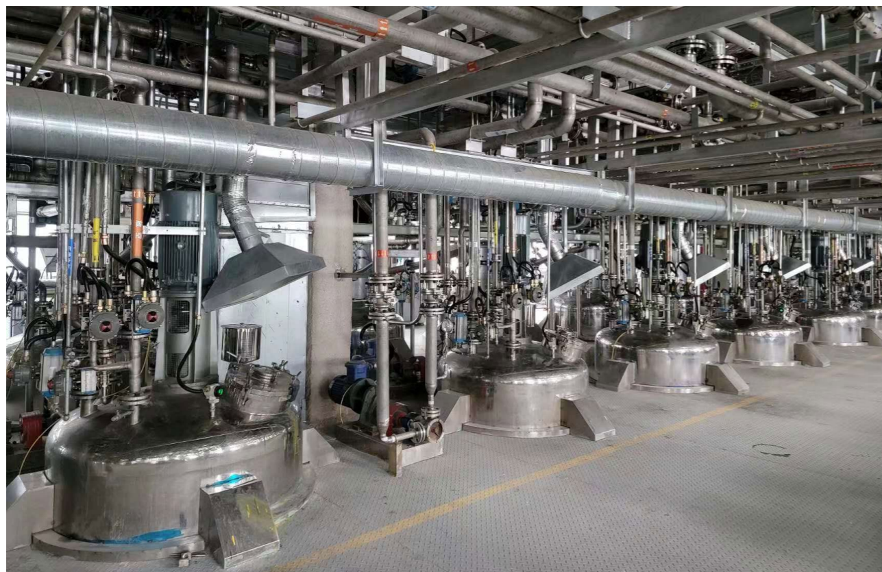
灯塔涂料车间
