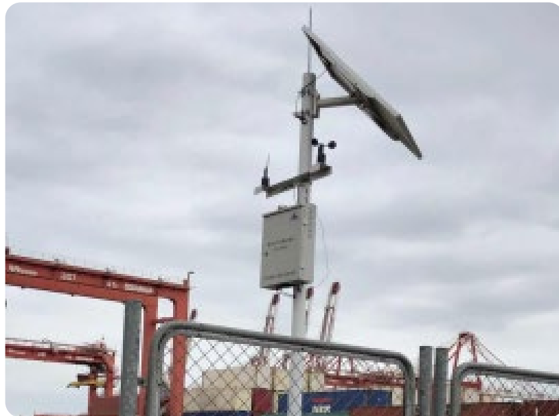
↑ 大气智能监测系统设施照片
