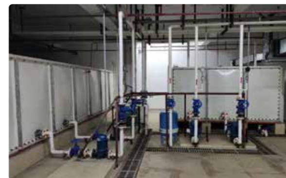
雨水收集站房
