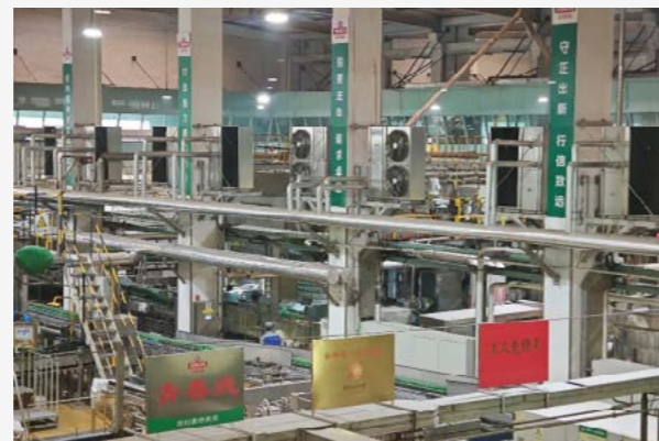
青岛啤酒二厂包装空气源热泵机组
