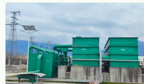
雨水回收和净化装置
