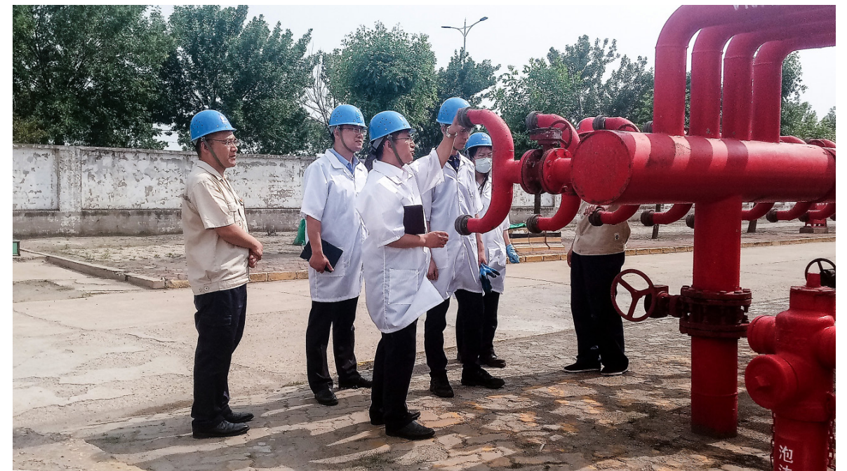
外部专家排查设备安全隐患
