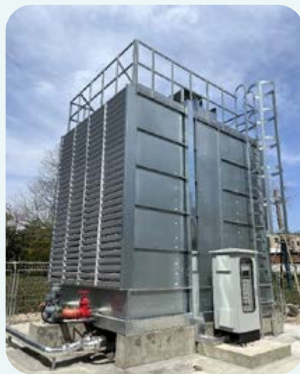
上海电气绿氢制 - 储 - 用一体化示范项目
