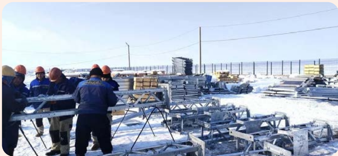
扎法拉巴德 220 千伏变电站项目
