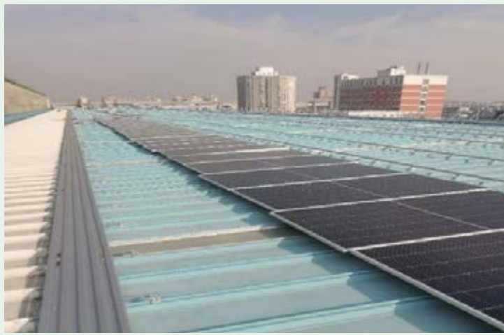
上海电气汽轮机厂屋顶光伏
