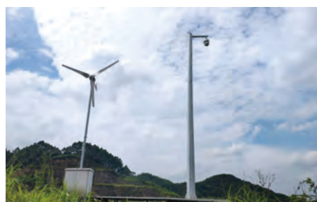
華新參天公司礦山小型風力發電系統
