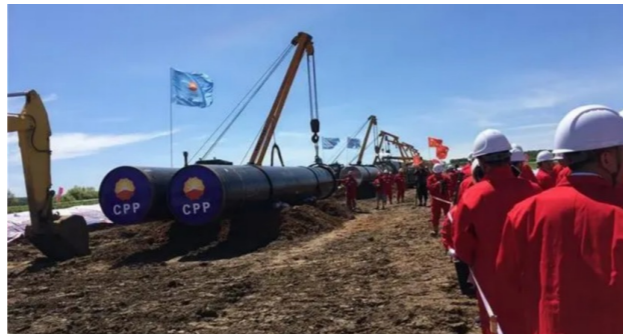
公司产品应用于世纪工程中俄东线天然气管道
