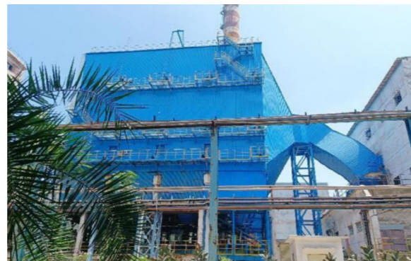
烧结机头电除尘
