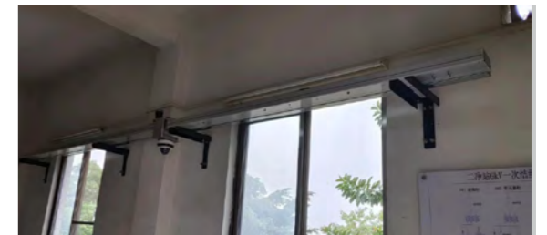
▲ 智能监控巡检轨道机器
