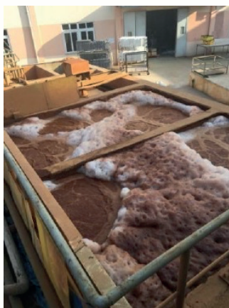
J.Y. Plasteel 透過微生物處理生活污水
