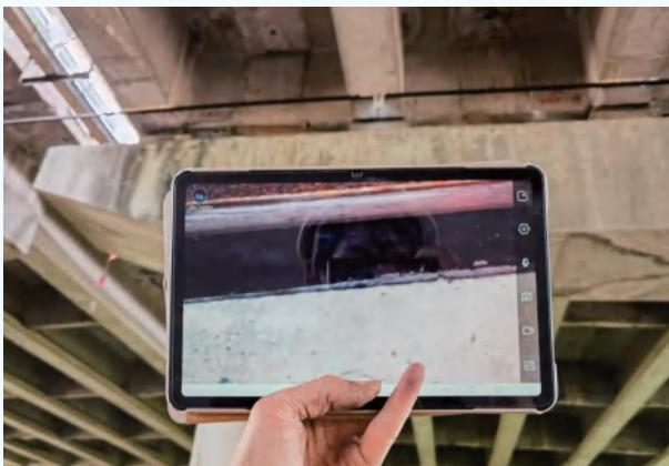
寧波管理中心研發橋樑支座智能巡檢裝置，保證檢查準確性的同時，提升檢測效率，降低作業風險
