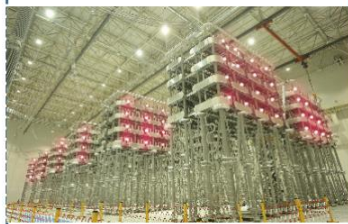
张北柔直工程换流阀厅
