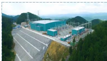
渝鄂柔直工程换流站
