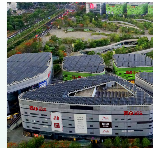
海口日月广场屋面光伏面板
