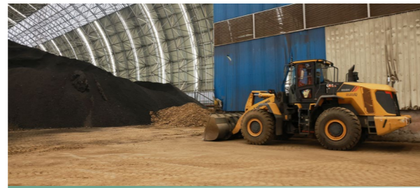
燃煤耦合污泥发电掺配现场
