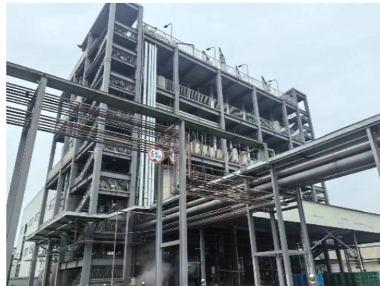
溶剂回收装置
