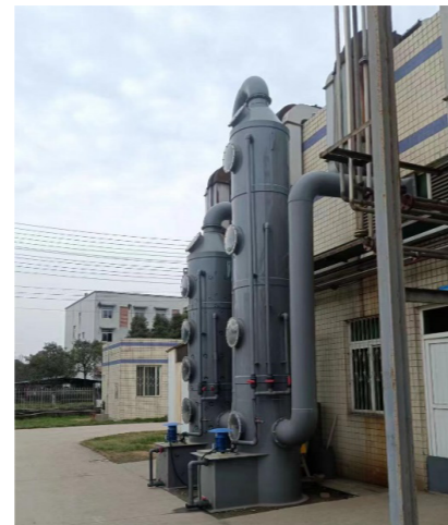
废气治理系统
