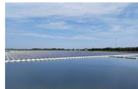
沛縣弘岳漂浮光伏電站： 規劃用地全部為採煤沉陷區閒置水面；並實現對水域環境的長期保護。
