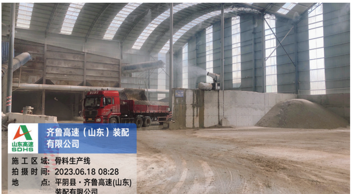
骨料生產線車間噴淋和霧炮降塵
