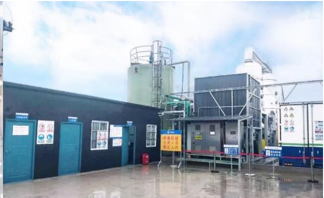
湖北洪湖渗滤液全量化处理项目
