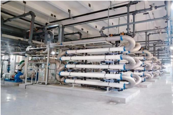
华电集团邹县电厂软化除硬项目
