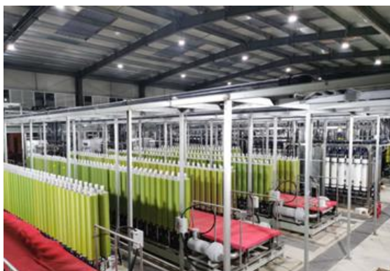
中石油长汀催化剂高含盐废水处理项目-DT 膜设备
