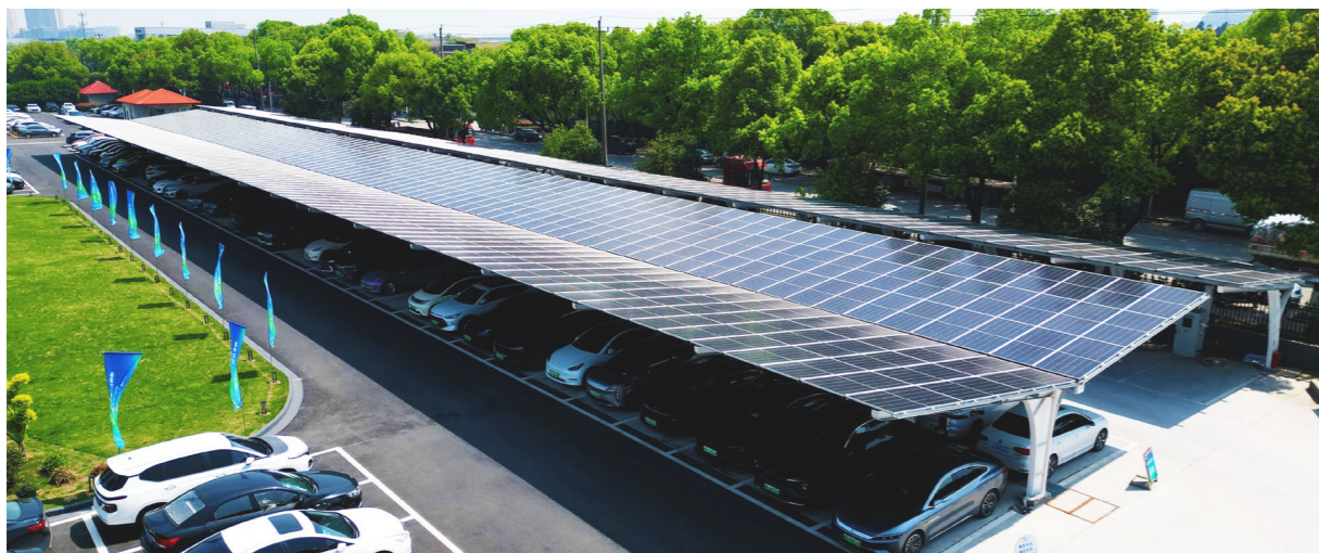
精工科技厂区太阳能光伏新能源汽车充电站
