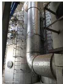
噴漆廢氣噴淋塔
