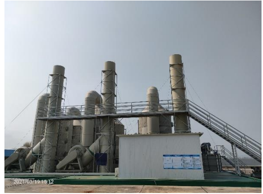
酸霧廢氣處理設施
