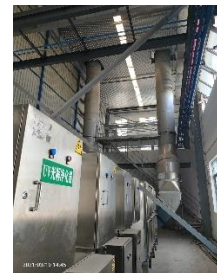
噴漆廢氣 UV 光解及高空排放
