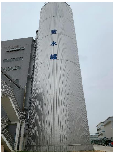
儲水罐 - 蓄冷/空調設備
