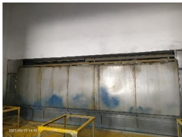
噴漆廢氣水簾收集
