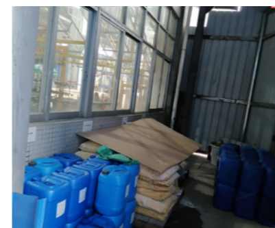
污水处理站隐患整改前
