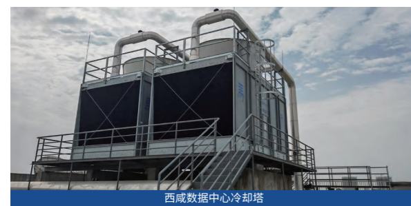
西咸数据中心冷却塔
