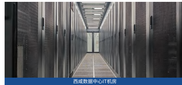
西咸数据中心IT机房
