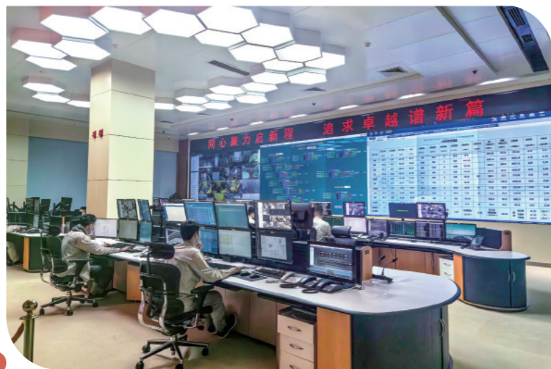
◎ 桂冠电力(红水河)集控中心
