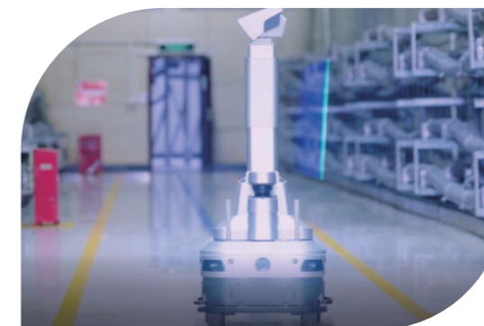
龙滩水力发电厂运用巡检机器人巡检,有效提升设备的巡检水平
