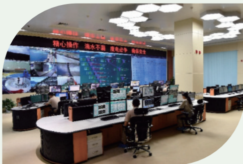
桂冠电力(红水河)集控中心
