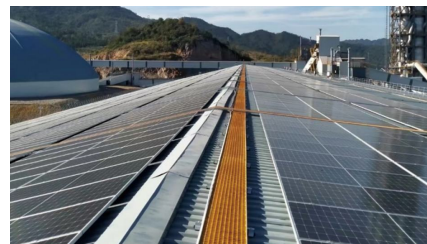
「贵州都匀」分布式光伏发电项目
