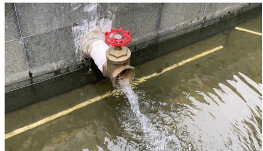
改造後的排水管
