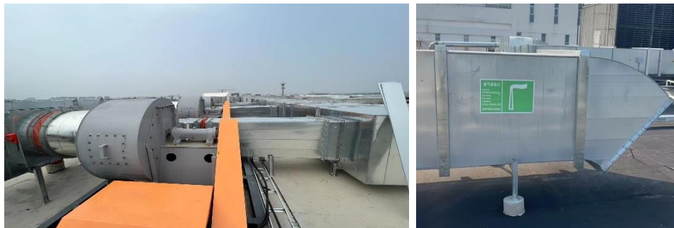
废气处理设施照片
