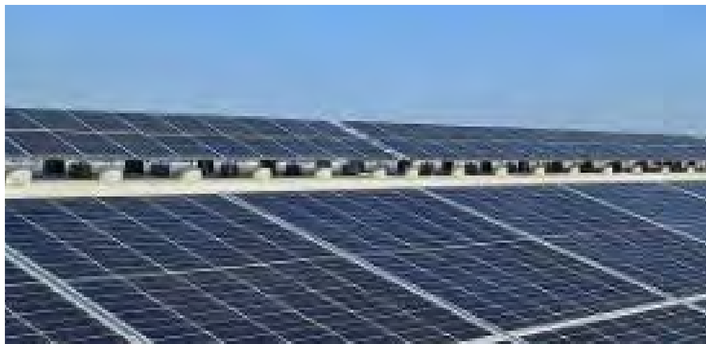
铜陵铜箔公司光伏发电项目
