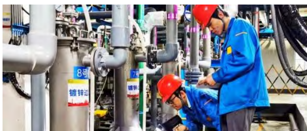
特种箔配液工段点检管道漏液情况
