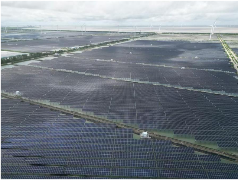
图：如东外农万亩渔光 600MW 光伏项目
