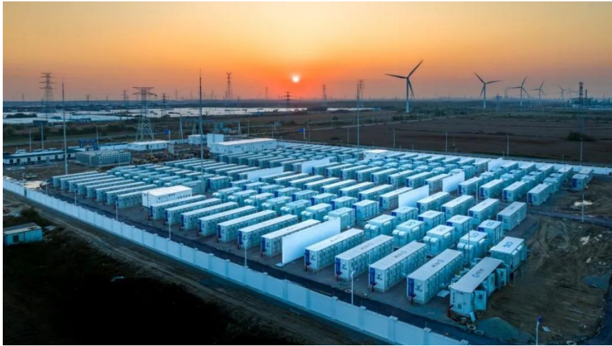
图：江苏丰储 200MW/400MWh 共享储能项目
